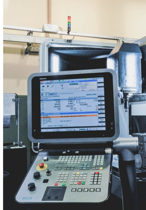
Les colonnes lumineuses ont été installées au-dessus des machines et sont également visibles
